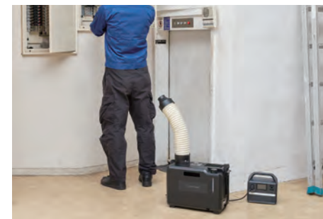
建物の設備メンテナンス
