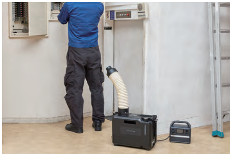
建物の設備メンテナンス
